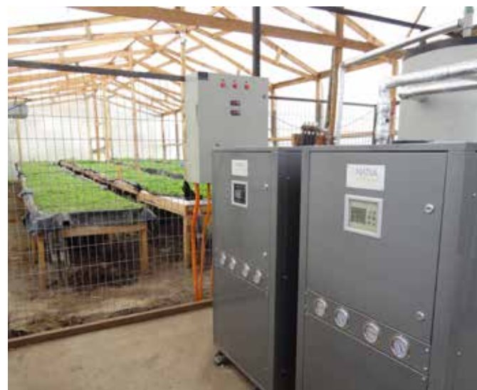
Invernadero con bomba de calor geotérmica.
